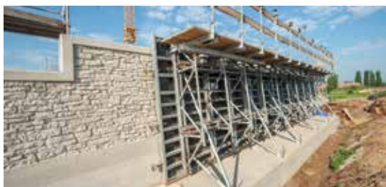
Hochwasserschutzwand aus Beton mit einer dreidimensionalen Optik
